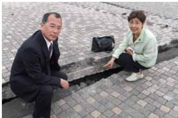
▲空洞と亀裂、段差の公園の敷地、 かち都議とともに調査
