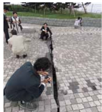
▲川崎市議団と一緒に多摩川河口に面した東扇島西公園の亀裂
