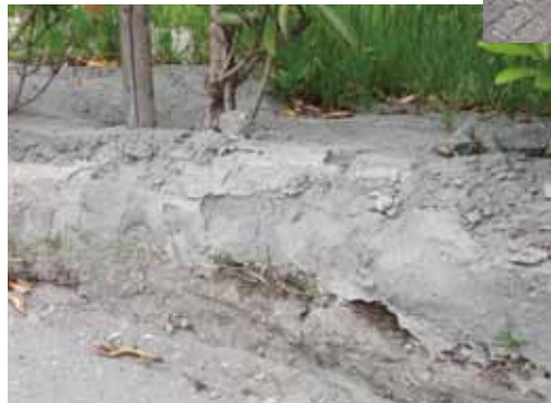
▲液状化で道路に噴き出した 目からいづばいの砂
