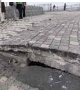
▼歩けないほどの亀裂
