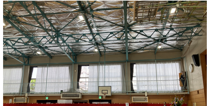
体育館の天井に設置された輻射熱反射シートと遮熱カーテン
