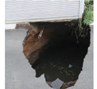
陥没当日、里吉都議撮影
